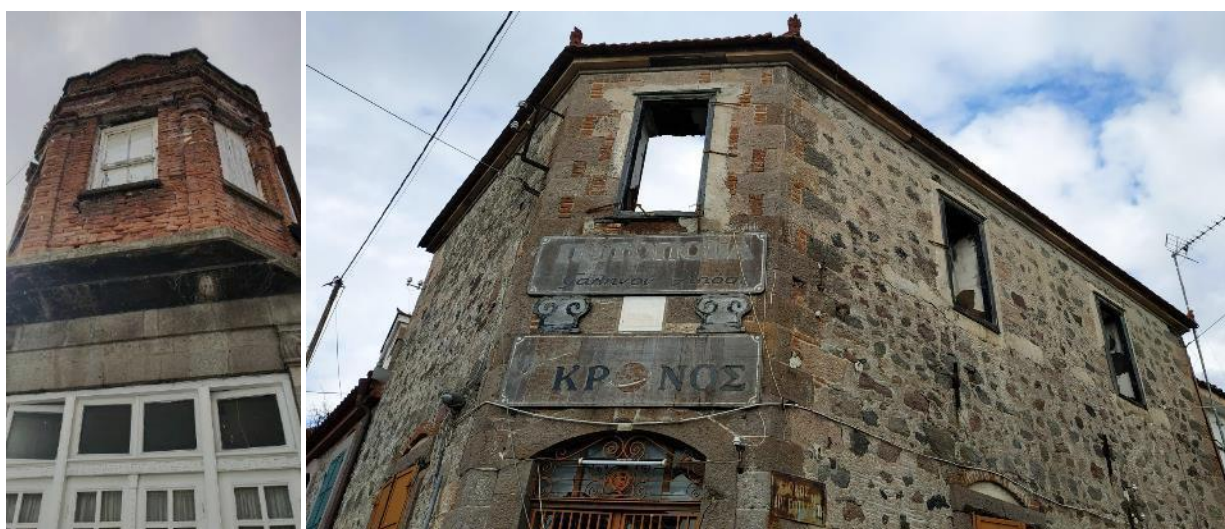
Εικόνα 42. Αριστερά: χαρακτηριστικό παράδειγμα με εμπορικό κατάστημα στο ισόγειο και γραφεία Λέσχης στον πρώτο όροφο. Δεξιά: το κτίσμα του τότε ποτοποιείου «Κρόνος» με υψηλή παθολογία.
